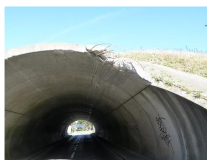
Photo de défaut trop éloignée
