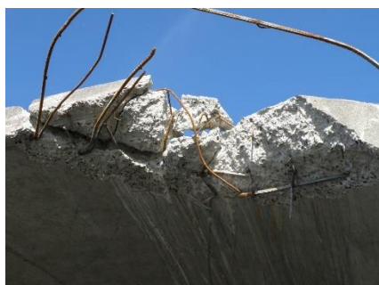
Photo de défaut assez proche
