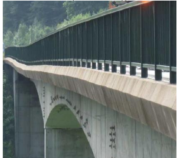
1972 – déformée liée à la non-prise en compte du fluage et du gradient thermique
