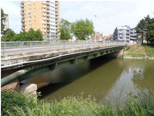
Les appuis de l'ouvrage sont partiellement visibles depuis les berges du canal
