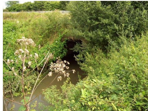
L'ouvrage n'est ni accessible ni visible en raison de la végétation qui envahit les abords et de la présence d'un cours d'eau
